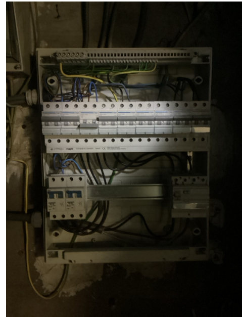
( Elektrisch bord - binnenkant )
