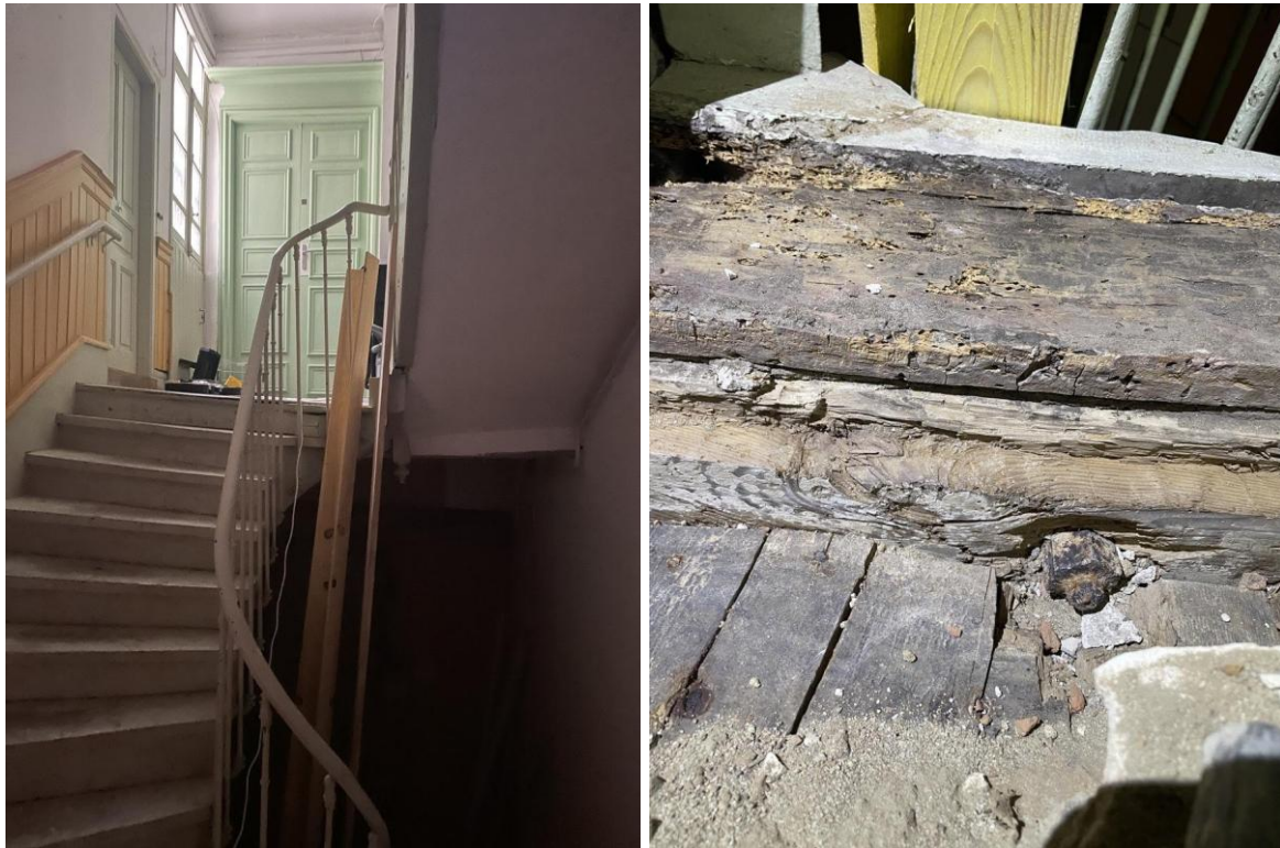
Figure 1 : Palier R+1 - Rupture de la poutre palière
