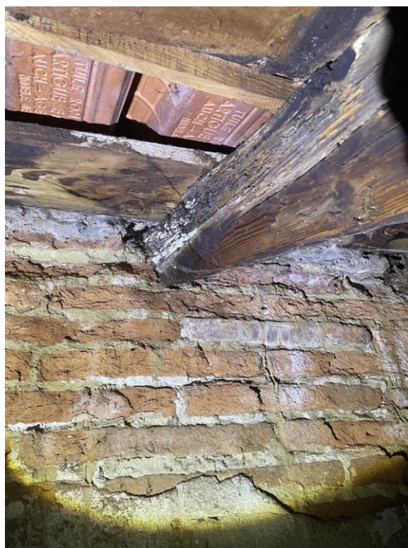
Figure 5 : Photo des chevrons dégradés
