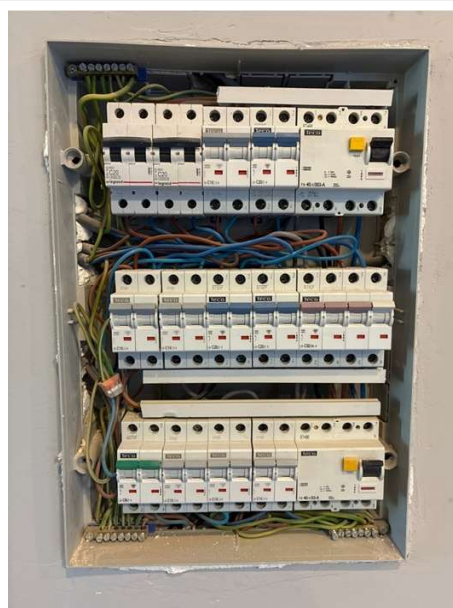
( Tableau électrique - intérieur )
