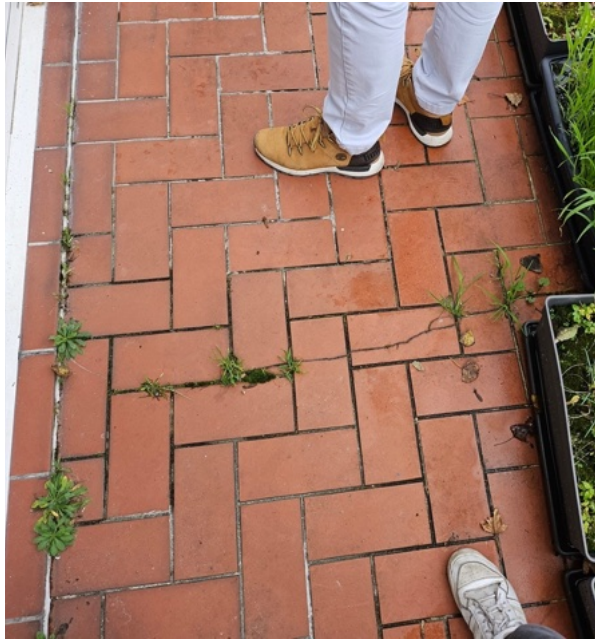
Au n°3, 8 ème étage, en façade avant (Delvaux) Fissure et verdurisation du balcon
