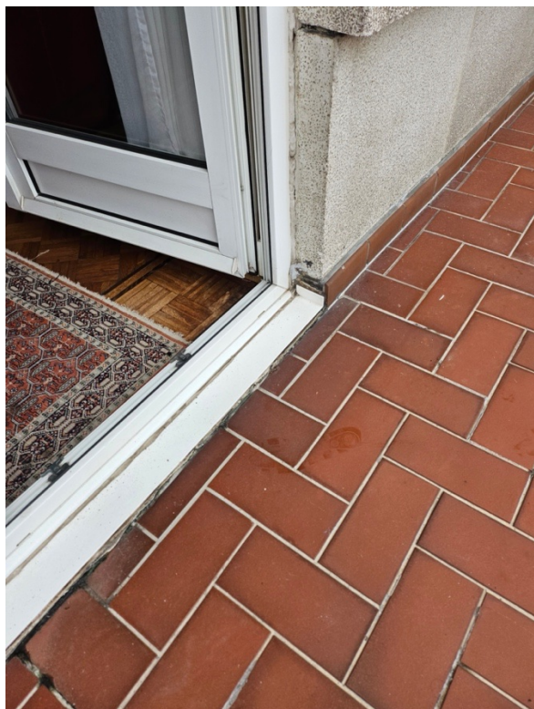
Au n°2, 8 ème étage, en façade avant (Sohy) Absence de relevé d'étanchéité.
