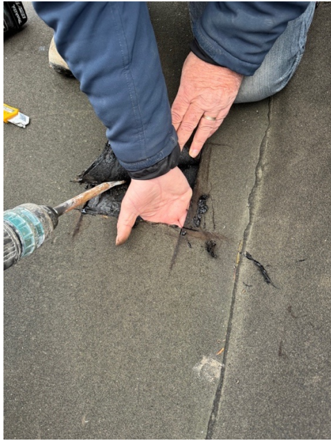
Couche de membrane bitumineuse facilement soulevable, n'adhérant pas aux couches inférieures
