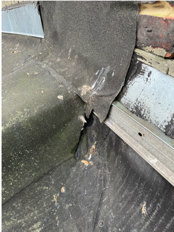
Non continuité de la membrane bitumineuse
