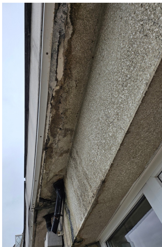
Au n°4, 8 ème étage, en façade avant (Bertrand) Fuites provenant de l'avaloir de la terrasse du dessus
