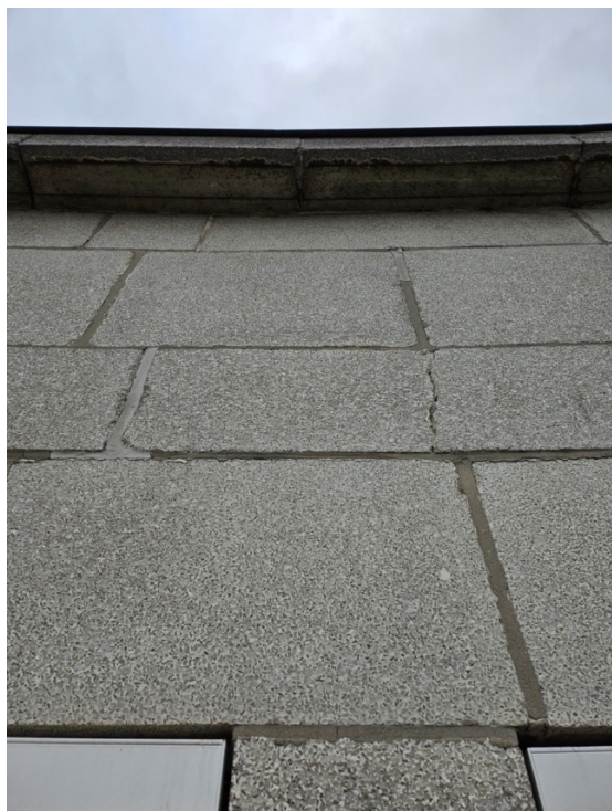
Au n°3, 9 ème étage, en façade av. (Loncour) Dégradation des joints et fissure.
