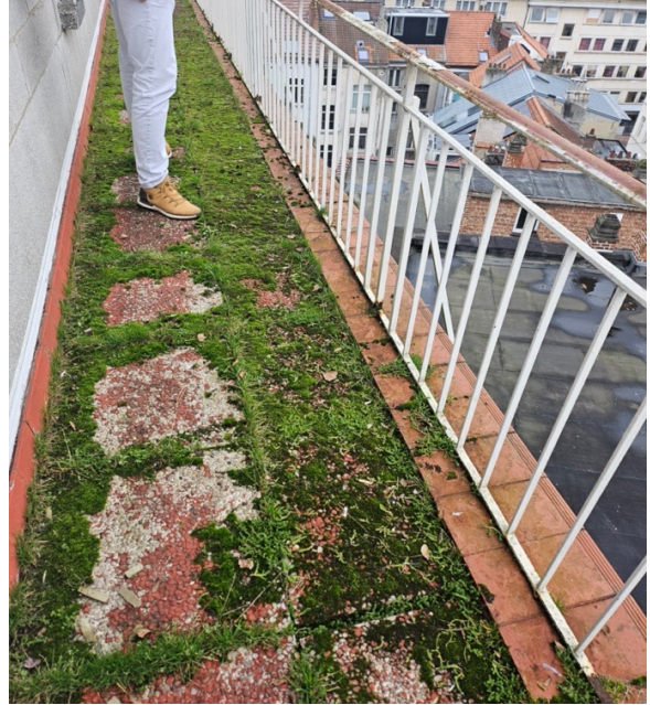
Terrasse au n°7, 9 ème étage, façade latérale (Tiberi) Verdurisation de la terrasse et corrosion du garde-corps
