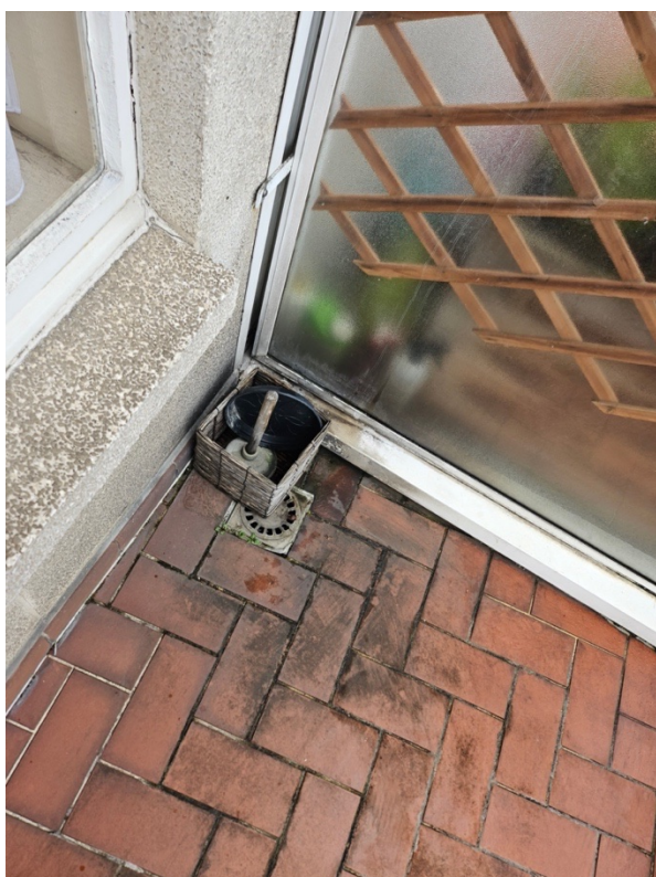
Au n°5, 9 ème étage, en façade avant (Sohy) Traces d'humidité sous forme de coulée verte
