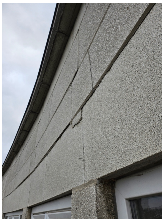
n°4, 9 ème étage, façade av. (Rauis) Désalignement des dalles de béton et fissure
