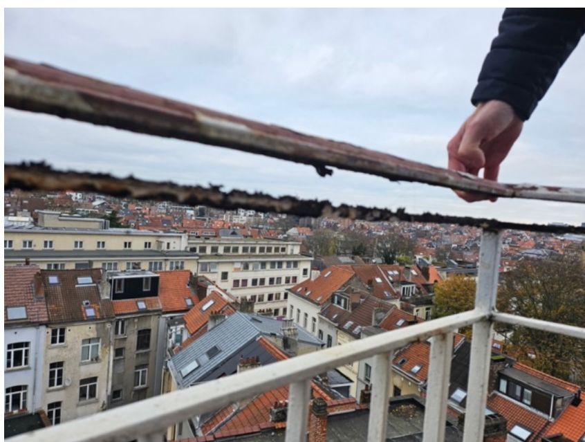
Au n°7, 9 ème étage, en façade latérale droite. Corrosion du garde-corps et désolidarisation de la main courante.
