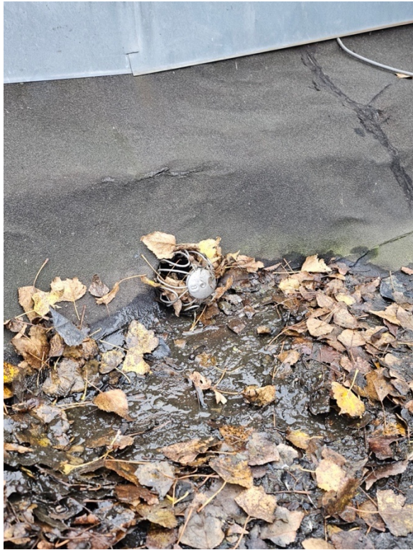
EP bouchée sur la toiture du n°6
