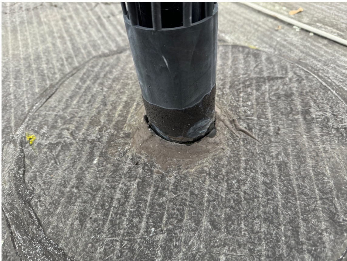
Infiltration d'eau autour d'une sortie de cheminée
