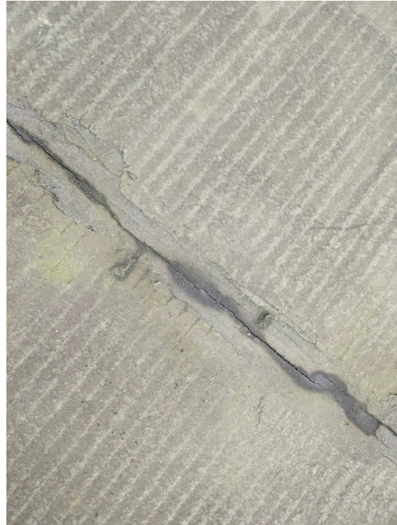
Exemple de fissure à la jonction des membranes bitumineuses
