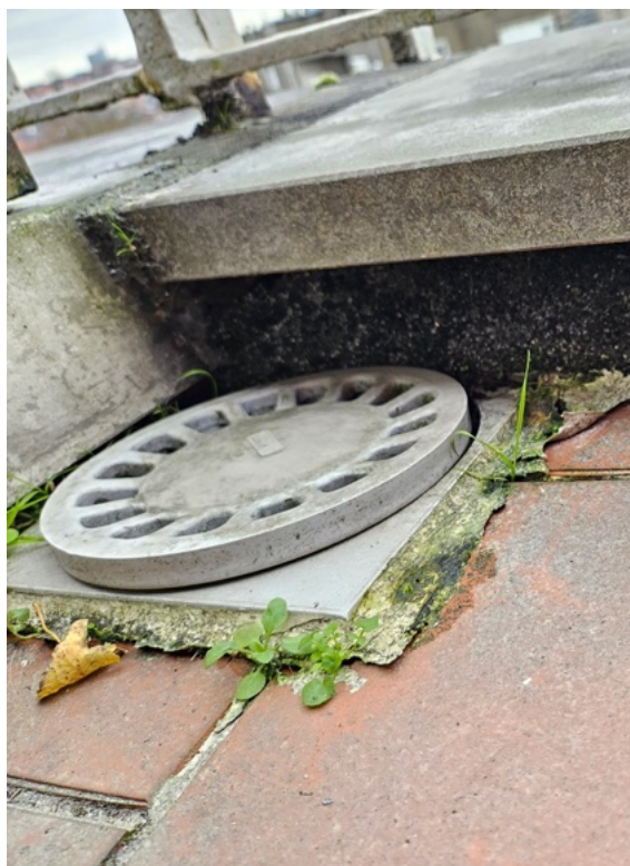
Au n°3, 9 ème étage, en façade avant (Boffa) Avaloir au-dessus du niveau fini de la terrasse
