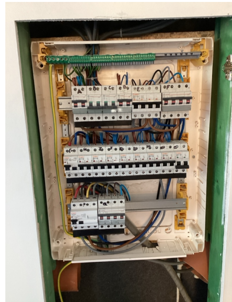
( Elektrisch bord - binnenkant )
