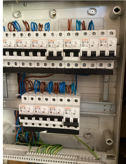
(Elektrisch bord - binnenkant)
