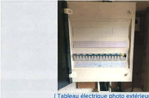
( Tableau électrique photo extérieur )
