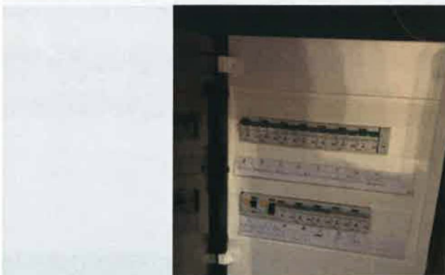
( Tableau électrique divisionnaire - Photo extérieur )
