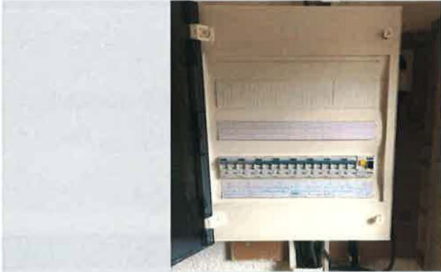
( Tableau électrique photo extérieur )
