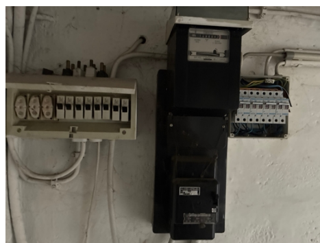
( Tableau électrique - intérieur )
