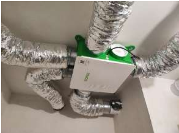
Une unité principale de la ventilation simple flux dans chaque appartements
