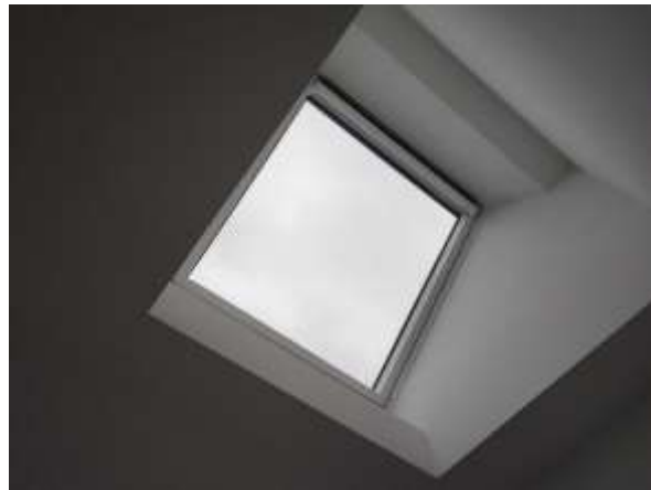
Exutoire de fumée
