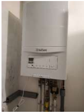
Vue d'ensemble de l'installation Vaillant
