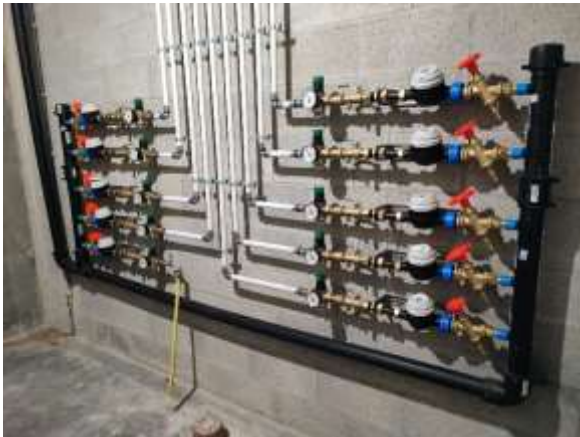
1 compteur d'eau par appartements située dans le local technique bloc E
