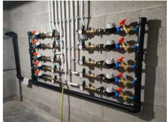
1 compteur d'eau par appartements située dans le local technique bloc F
