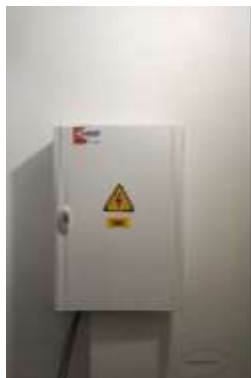
1 tableau de distribution dans chaque appartements
