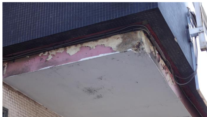
DÉGRADATION DES ÉLÉMENTS BÉTON
