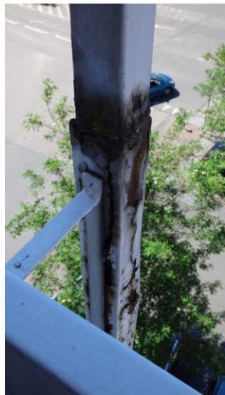
DÉGRADATION DES STRUCTURES MÉTALLIQUES
