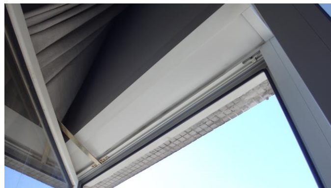
DÉGRADATION DU PAREMENT CARRELÉ
