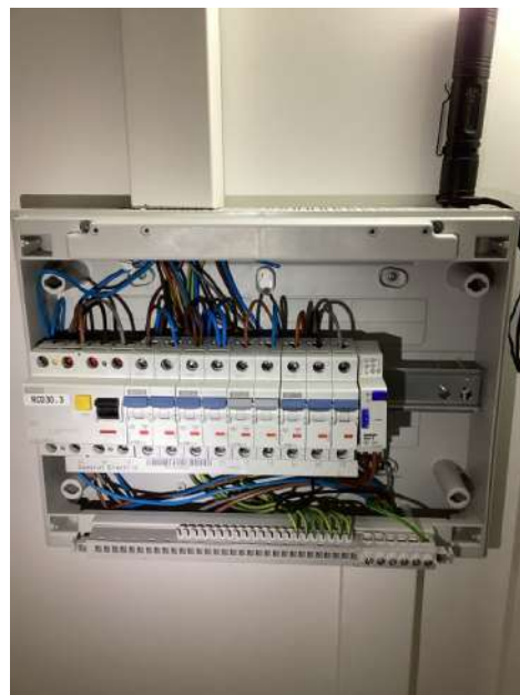
( Tableau électrique - intérieur )
