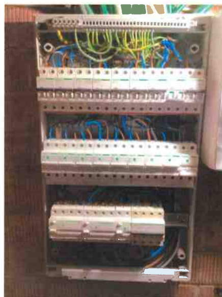
( Elektrisch bord - binnenkant )
